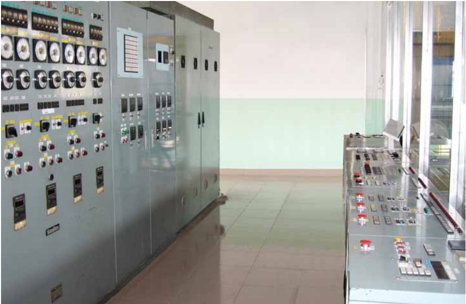
Phòng điều khiển hệ thống xử lý bề mặt
